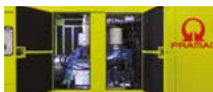
Grosse Türen für Wartung und Instandhaltung
