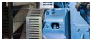
Rotierende Maschinenteile sind abgedeckt
