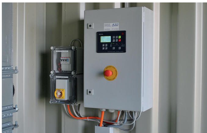
Steuerschrank und Netzumschalter
